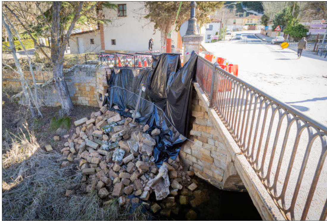
El puente medieval de la ciudad de Soria que resultó afectado por la borrasca. HDS
